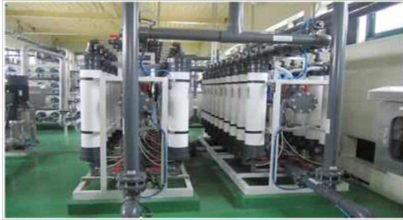
<그림 5-9> 채소용수 관개용 역삼투압 여과방식의 폐수처리 플랜트 ※ 자료 : 서부 폐수처리플랜트, 제주 판포와 월정 지구에 적용 및 운전 중
